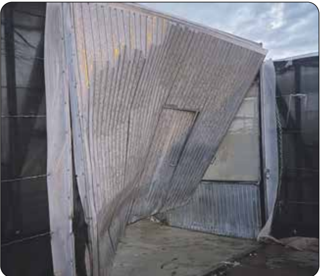
■ La fuerza de la corriente destruyó esta puerta. /DC
