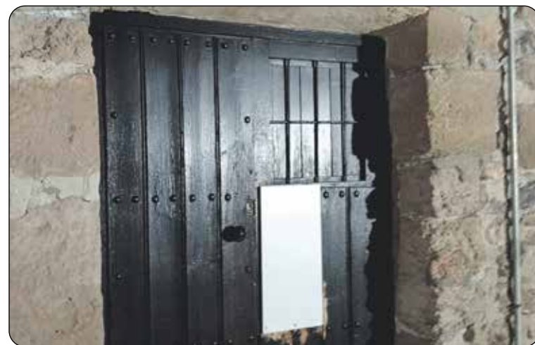
■ Daños en la puerta de la Iglesia Fortaleza de Vúcar Pueblo. /DC
